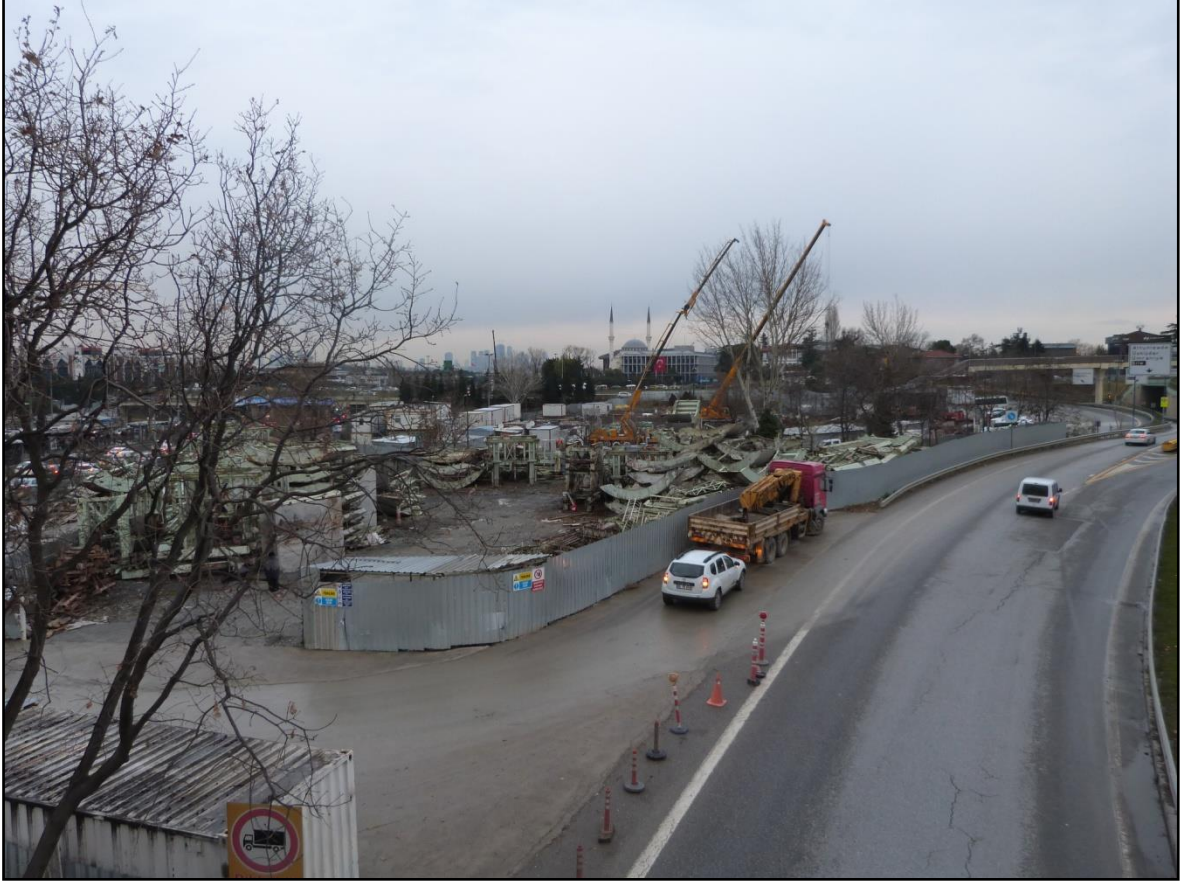
Şekil I.B.1.5 İnşaat Çalışmalarının Devam Ettiği Üsküdar – Ümraniye – Çekmeköy Metro Hattı Altunizade Mevkiinden Görünüm
